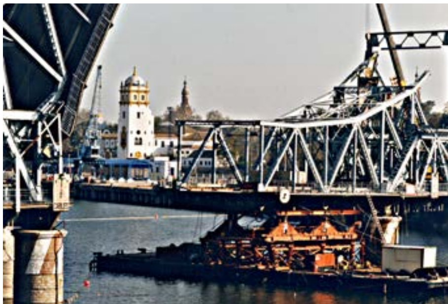
Figura 16. Trabajos de desmontaje y recolocación de los tableros del puente de Alfonso XIII en el muelle de Las Delicias. Año 1998. Archivo de la Autoridad Portuaria de Sevilla.
