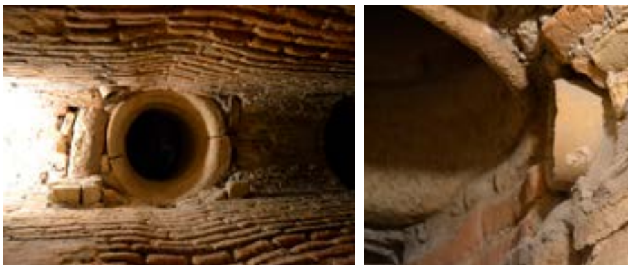
Figura 6. Cañería que conecta al aljibe con el Patio de los Naranjos a través de atanores, instalados en 1487 (fotografías del autor).
