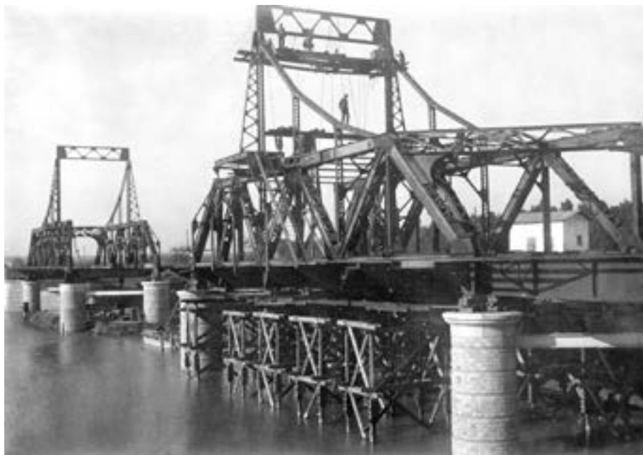
Figura 7. Construcción del puente de Alfonso XIII. s/f. Archivo de la Autoridad Portuaria de Sevilla.
