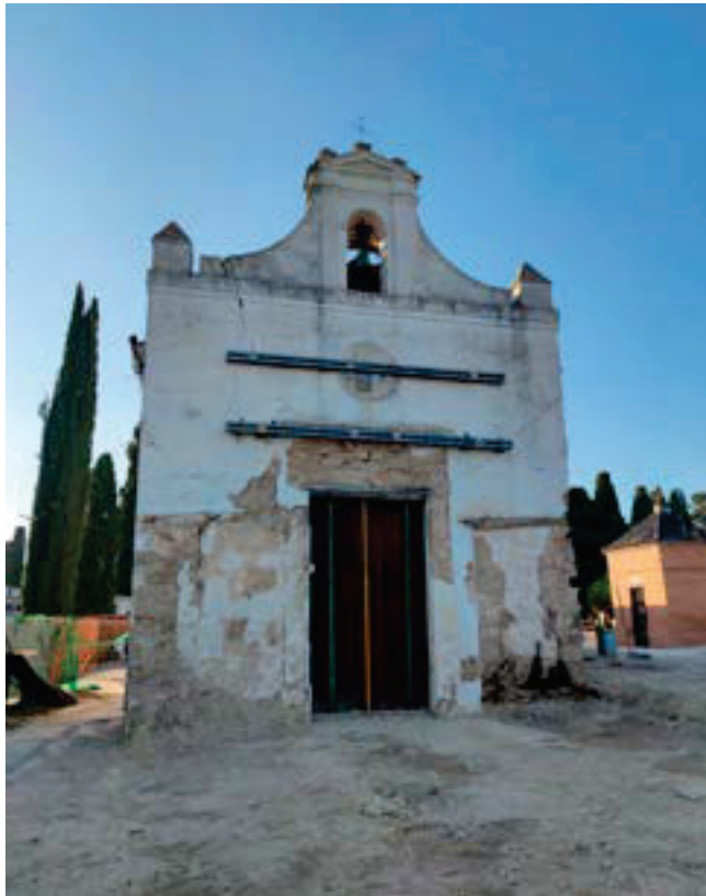
Figura 7. Actual capilla del cementerio municipal de Utrera, vestigio del antiguo convento de San Francisco el Viejo de Utrera (S. XVIII).
