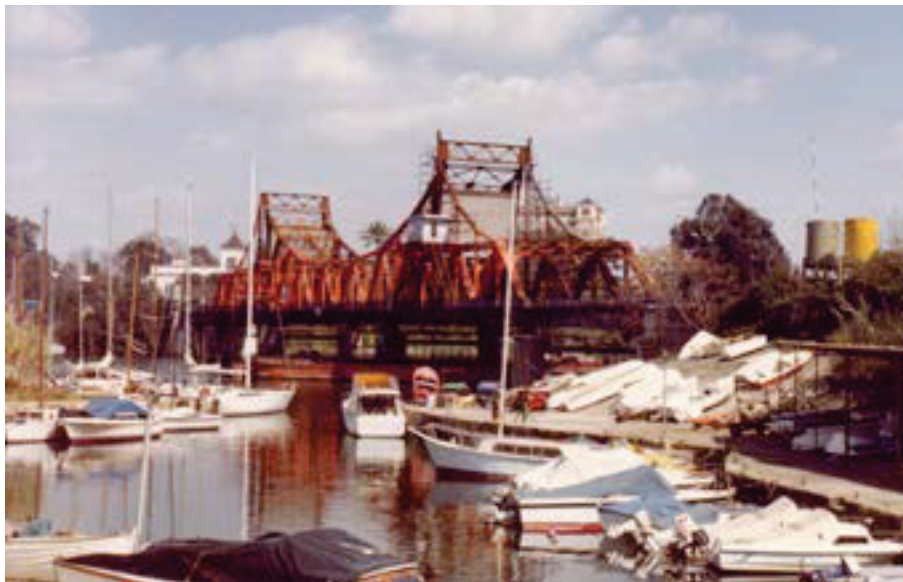
Figura 12. Obras de reparación del puente de Alfonso XIII. s/f (ca. 1983). Archivo de la Autoridad Portuaria de Sevilla.
